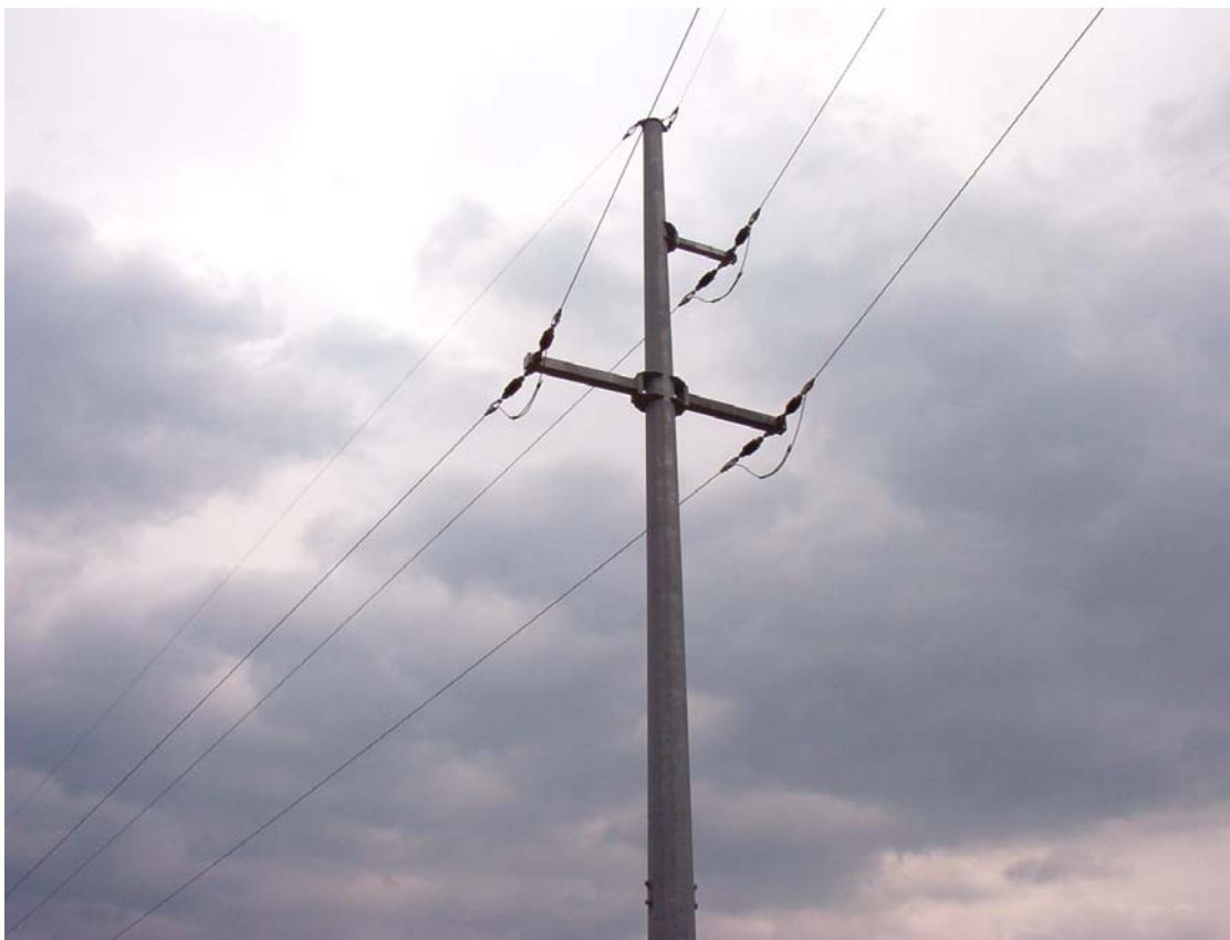
Cevasti stub od čelika u ulozi ugaono zateznog uporišta jednosistemskog 35 kV nadzemnog voda sa zaštitnim užetom
